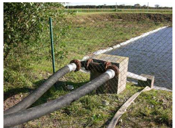
Deux sorties de 100 mm sur une colonne de 150 mm
