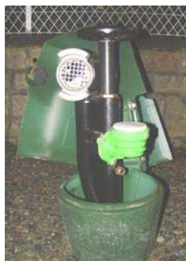
Intérieur d'une borne de puisage avec ½ raccord de 65 mm et compteur d'eau
