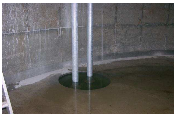
Fond de la cuve avec crépine sous le niveau le plus bas de l'eau
